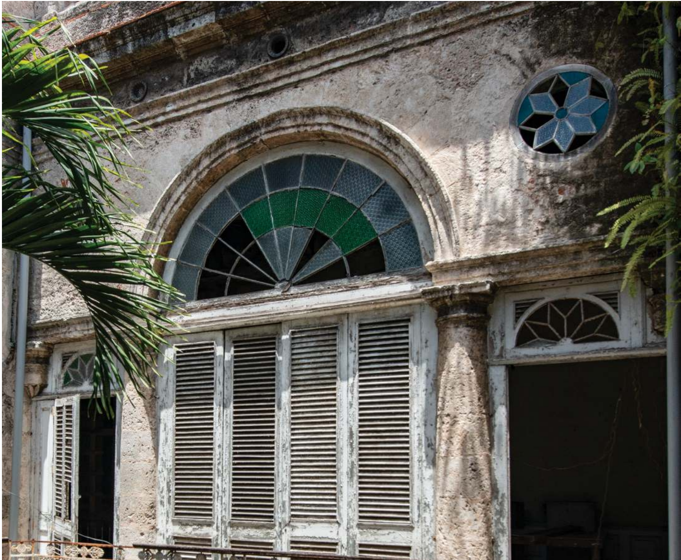
Modificaciones y deterioro de los cristales de los mediopuntos y de la carpintería
