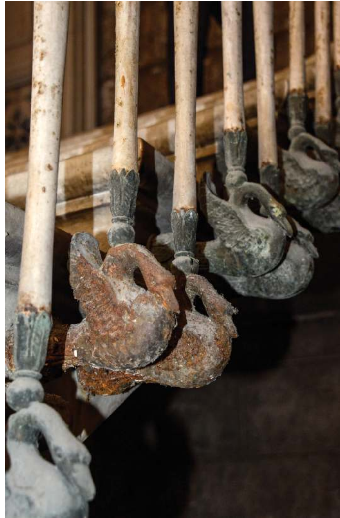
Oxidación de los hierros, baranda de la escalera principal de la casa de Domingo Aldama
