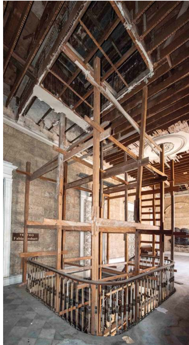
Daños en pavimentos y pérdida del cielo raso
