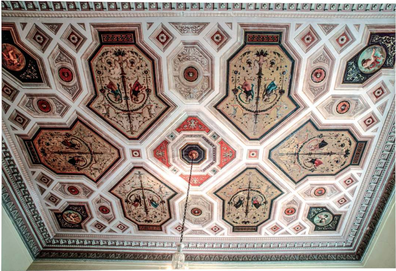
Sala de la casa de Domingo del Monte (cielo raso desaparecido)
