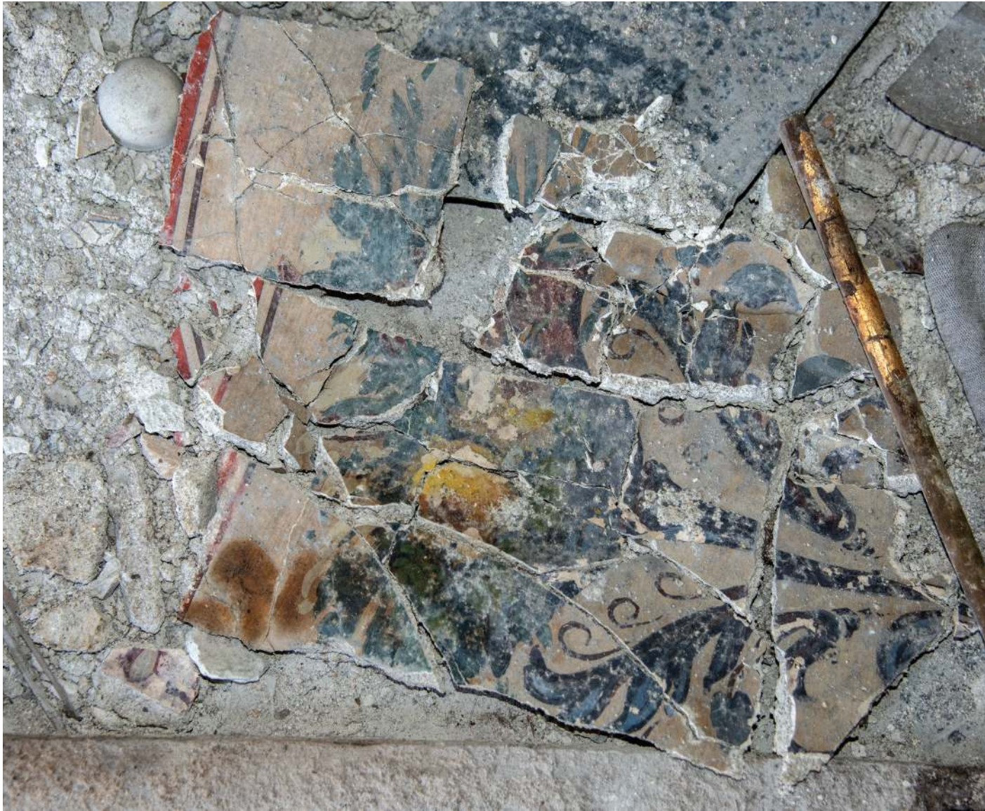
Desplome de las pinturas de los cielos rasos
